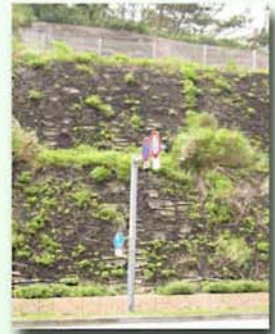
乾燥害による植生基盤の消失
